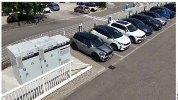
► Les bornes de recharge du site Socomec sont associées à des batteries de stockage pour optimiser l'utilisation de l'électricité photovoltaïque.
